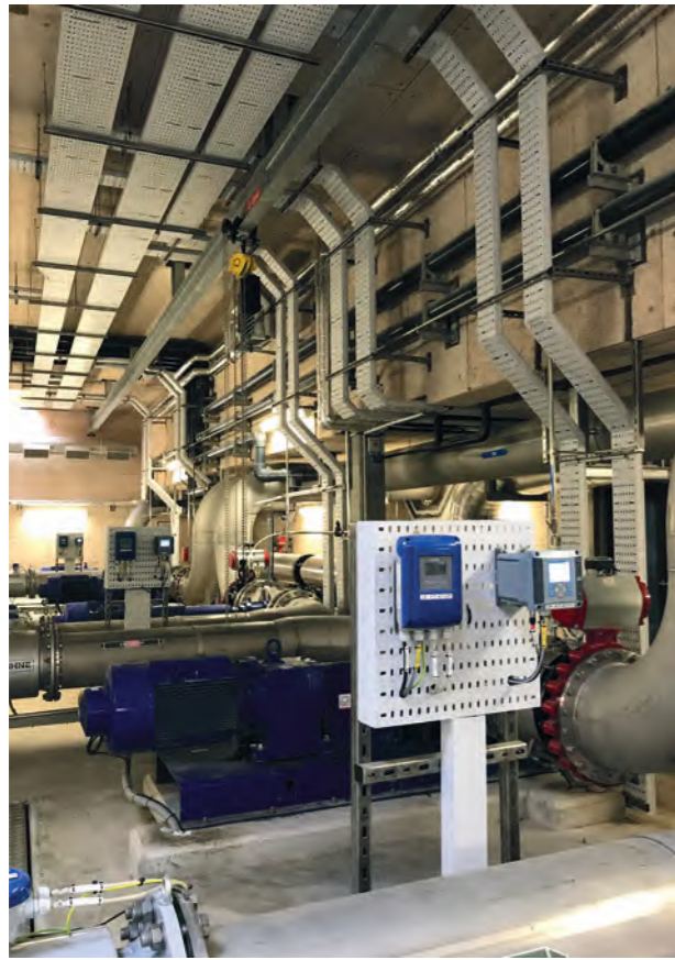
Tratamiento de aguas: EDAR
