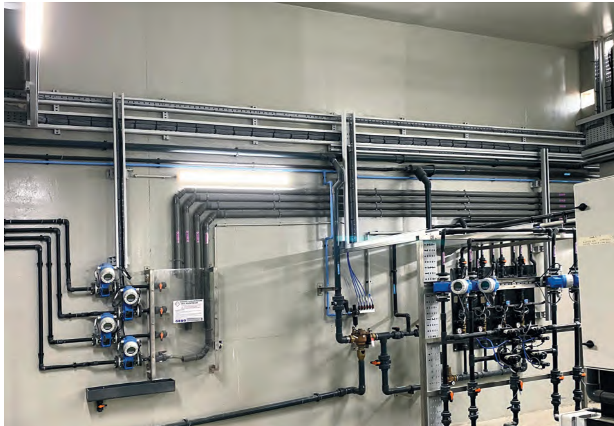
Tratamiento de aguas
