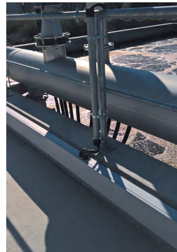
Tratamiento de aguas: EDAR
