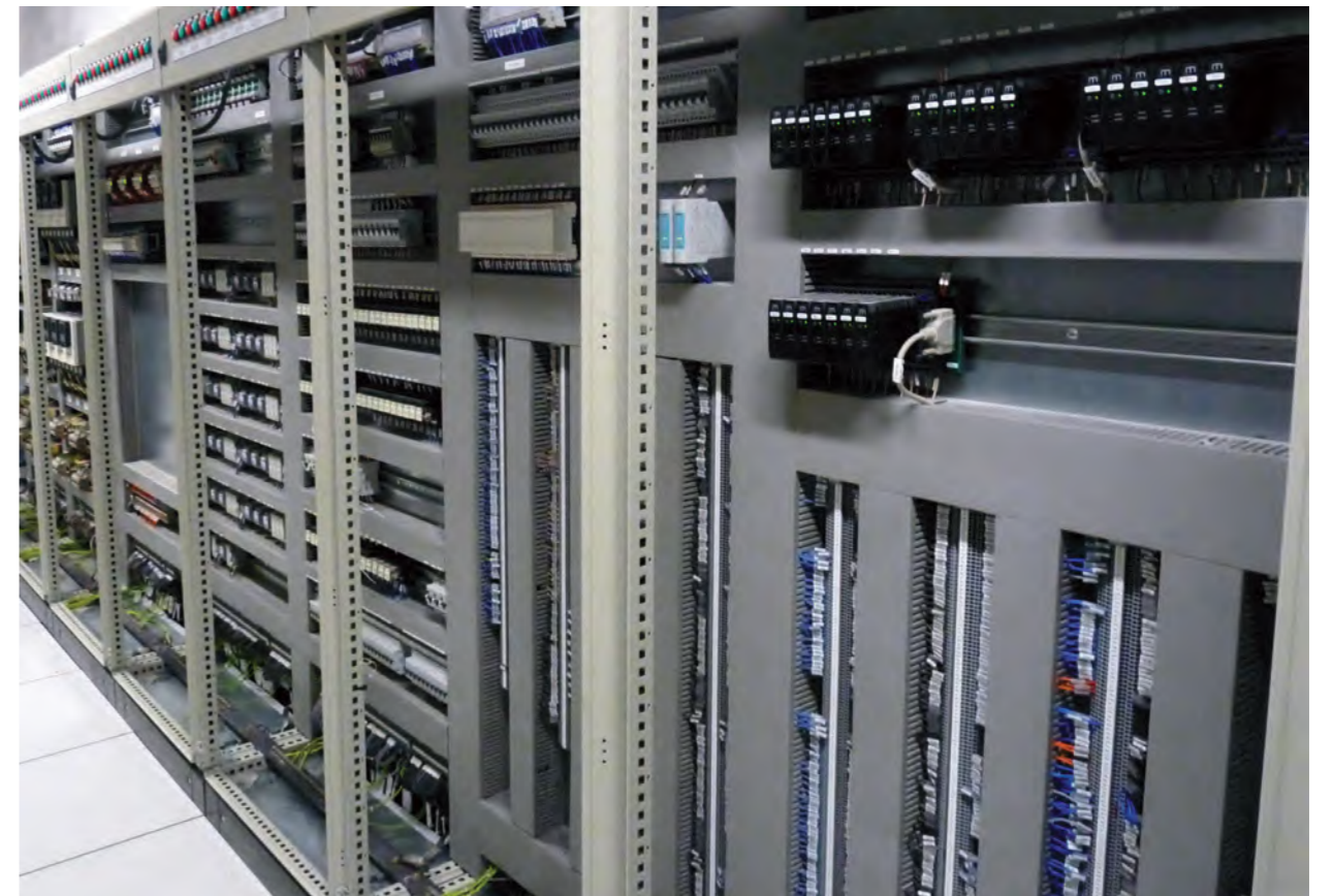
Tratamiento de aguas
