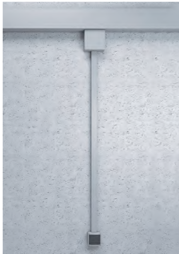
Nave industrial: alimentación de mecanismos
