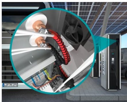
Concepto de conexión personalizado para su estación de recarga HPC
