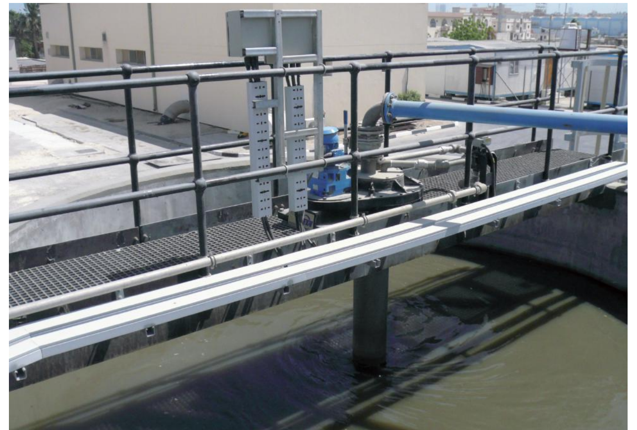
Tratamiento de aguas: EDAR
