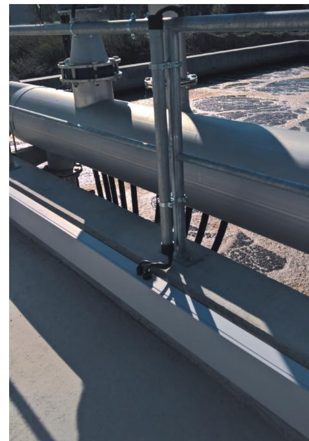
Tratamiento de aguas: EDAR
