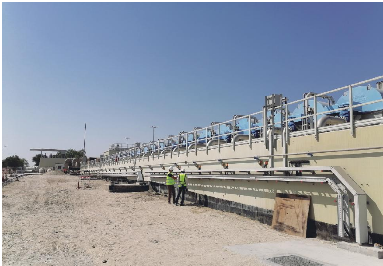
Tratamiento de aguas: EDAR
