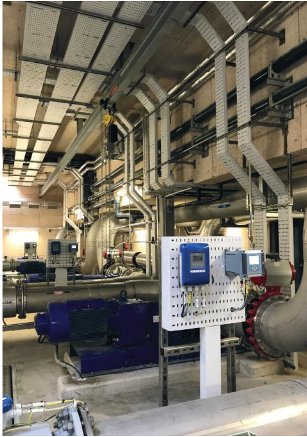
Tratamiento de aguas: EDAR
