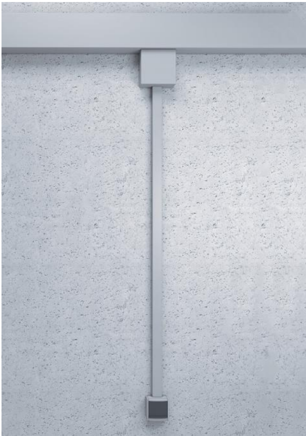
Nave industrial: alimentación de mecanismos
