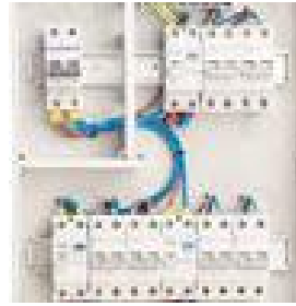
Amplio espacio para el cableado. Wide space for the cabling.
