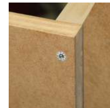
Evita que se agriete la madera
